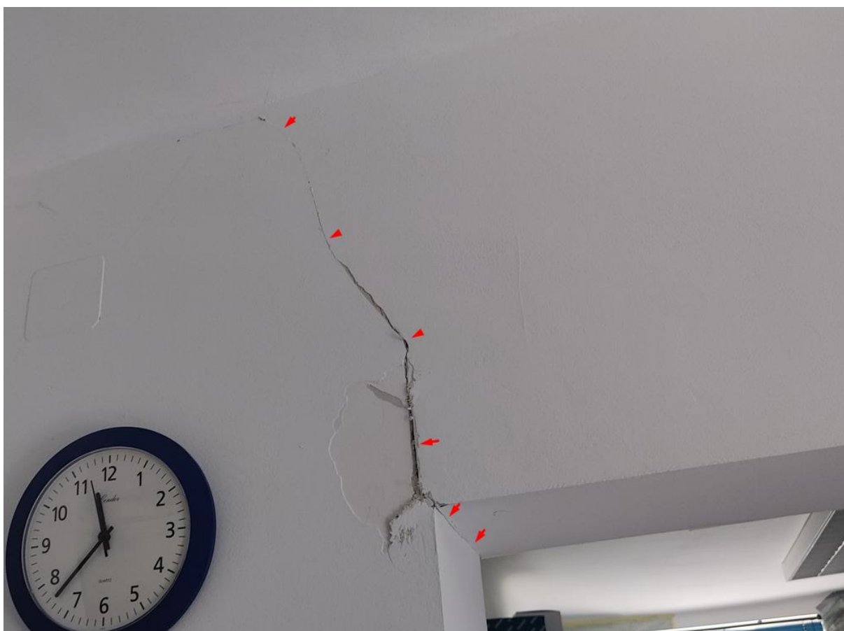
Slika 42 Pukotine na nadvoju iznad otvora na 2. katu – Pozicija 28
