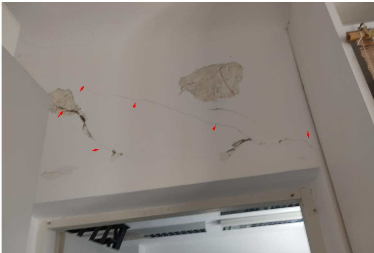
Slika 49 Pukotine na nadvoju iznad otvora na 2. katu – Pozicija 34
