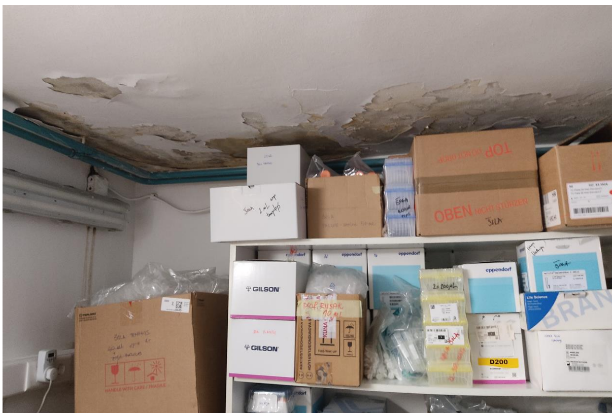
Slika 16 Oštećenja na stropnoj konstrukciji podruma nastala djelovanjem vlage – Pozicija 5
