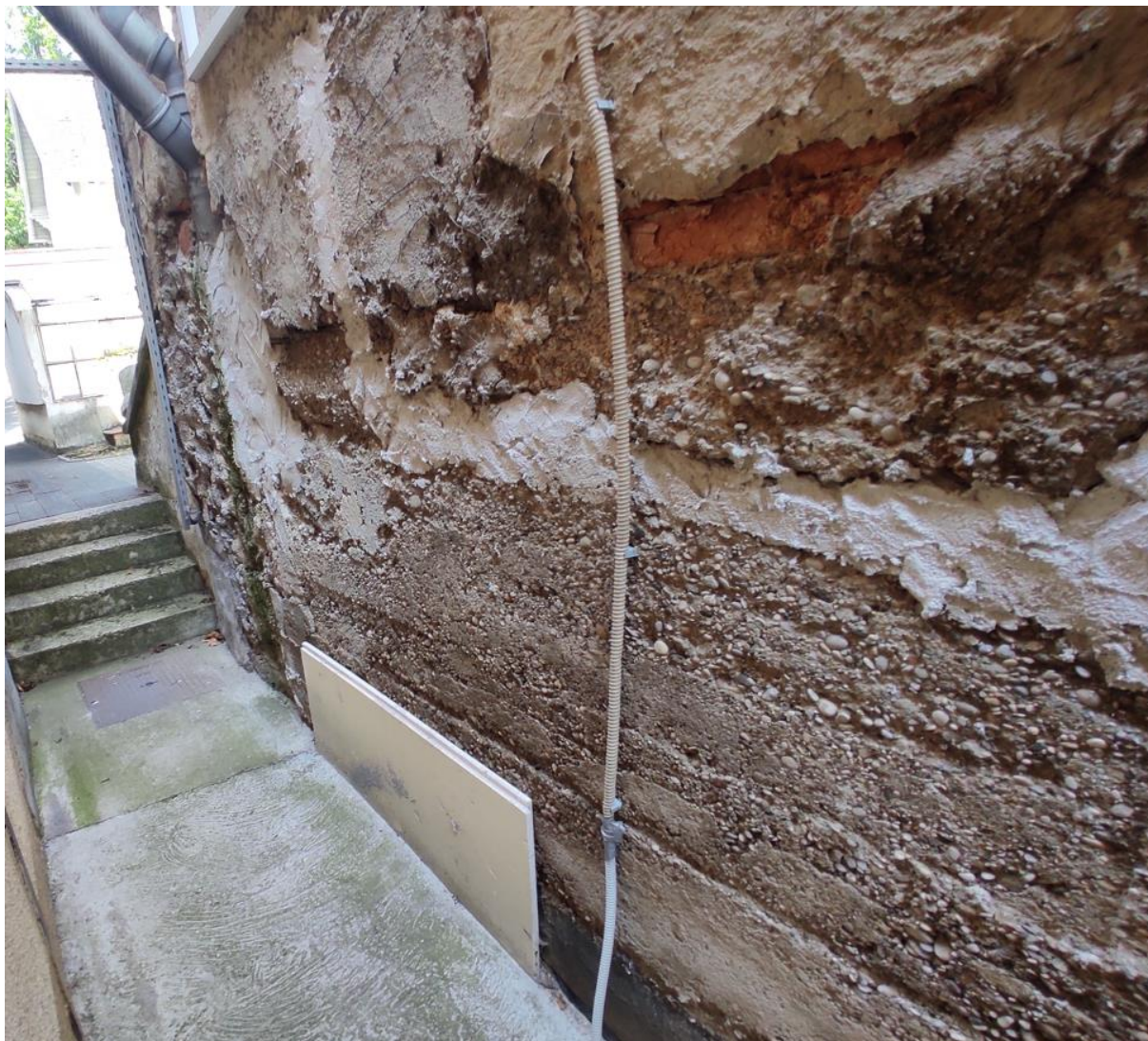
Slika 15 Oštećenja završnih slojeva nosivih konstruktivnih elemenata– južno pročelje – Pozicija 4
