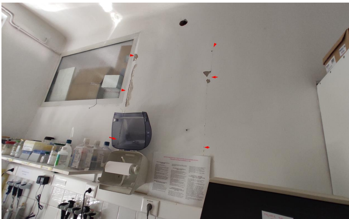
Slika 20 Pukotine na zidu u prizemlju - Pozicija 8
