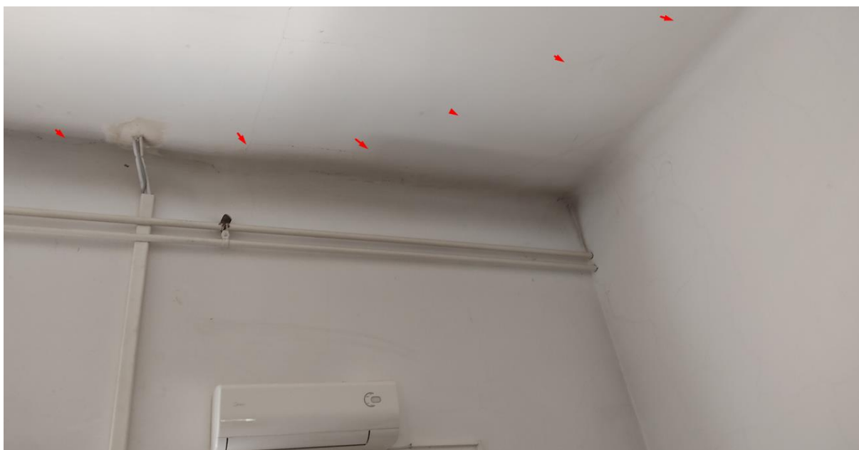
Slika 24 Pukotine na spoju zida sa stropnom konstrukcijom u prizemlju – Pozicija 13
