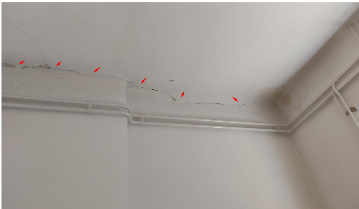
Slika 27 Pukotine na spoju zida sa stropnom konstrukcijom na 1. katu – Pozicija 15
