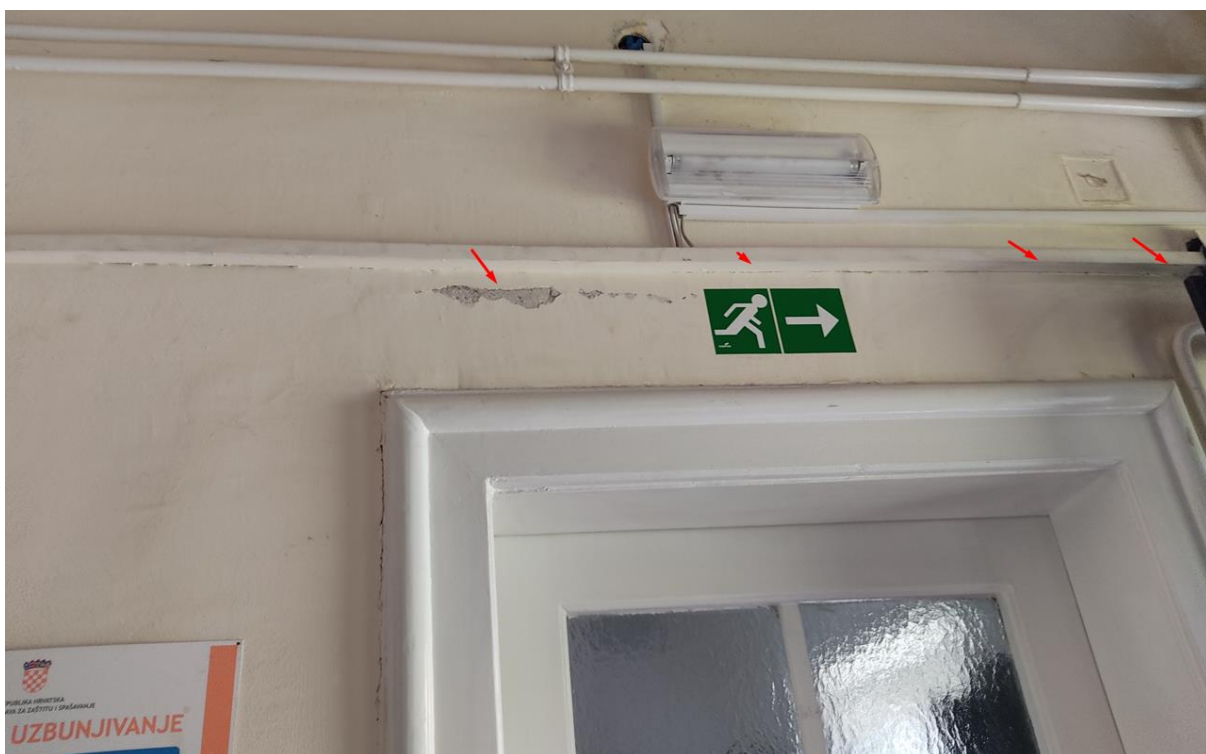
Slika 19 Pukotine na nadvoju iznad otvora u prizemlju– Pozicija 7
