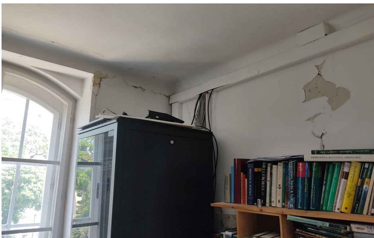
Slika 40 Pukotine zidu na 2. katu – Pozicija 26
