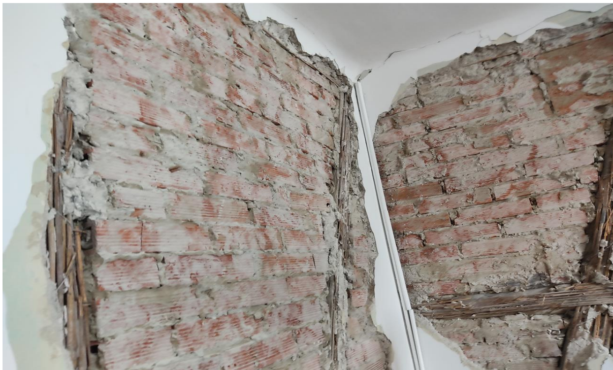
Slika 32 Oštećenja na mansardnom zidu izvedenom od komb. Opeke i drvenih elemenata na 2. katu – Pozicija 20
