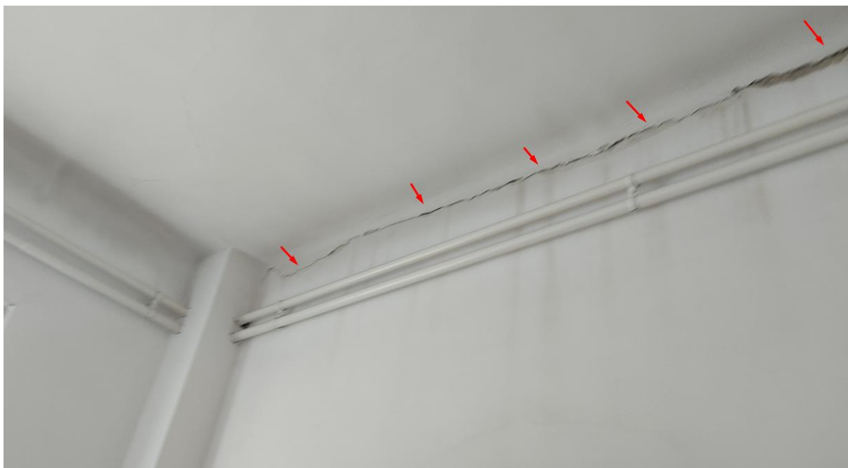
Slika 28 Pukotine na spoju zida sa stropnom konstrukcijom na 1. katu – Pozicija 16
