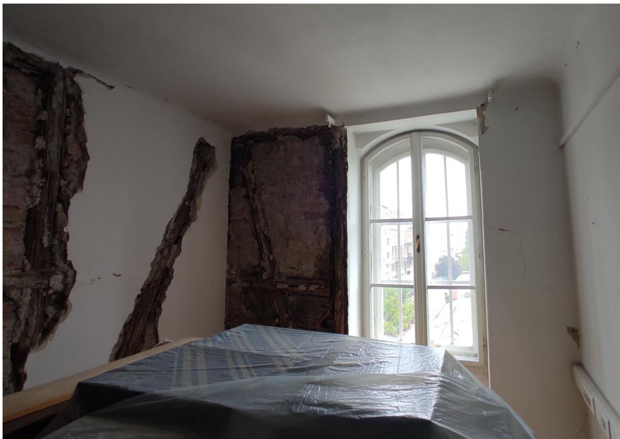
Slika 35 Oštećenja na mansardnom zidu izvedenom od komb. opeke i drvenih elemenata na 2. katu
