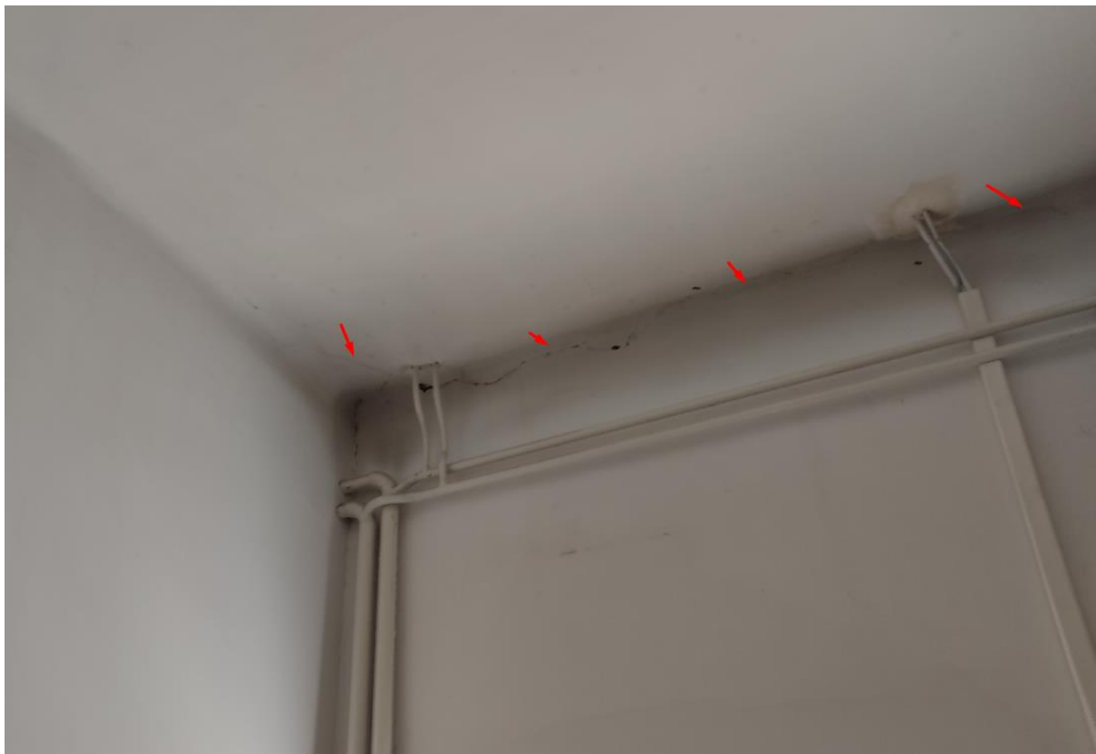
Slika 25 Pukotine na spoju zida sa stropnom konstrukcijom u prizemlju – Pozicija 12
