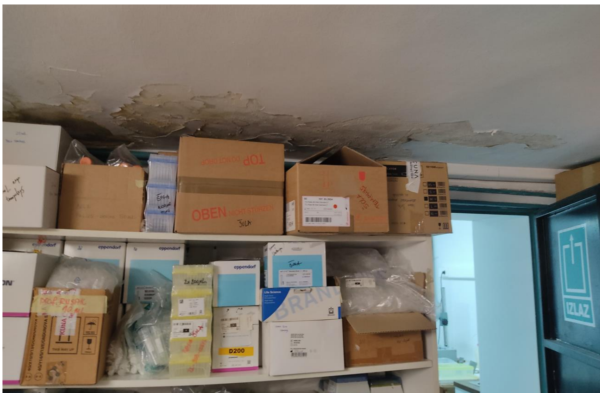
Slika 17 Oštećenja na stropnoj konstrukciji podruma nastala djelovanjem vlage – Pozicija 5
