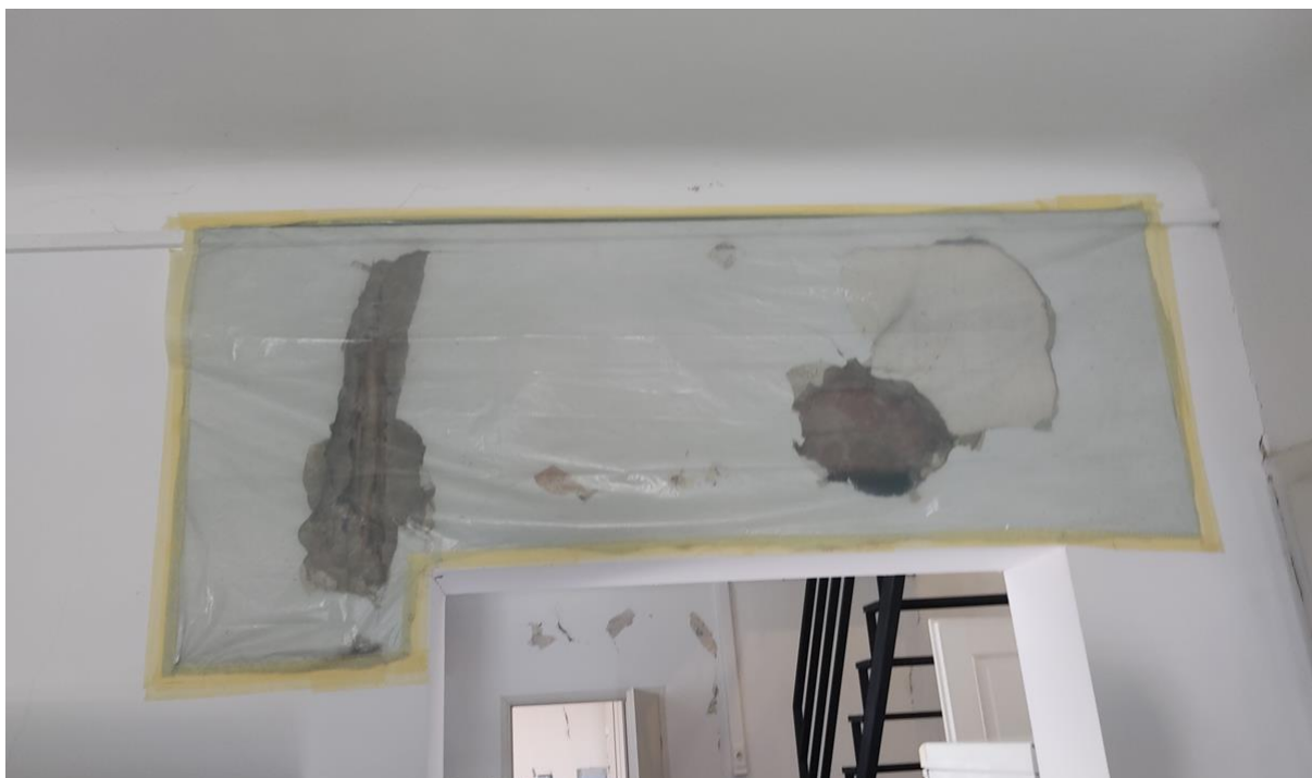
Slika 43 Pukotine na nadvoju iznad otvora na 2. katu – Pozicija 28
