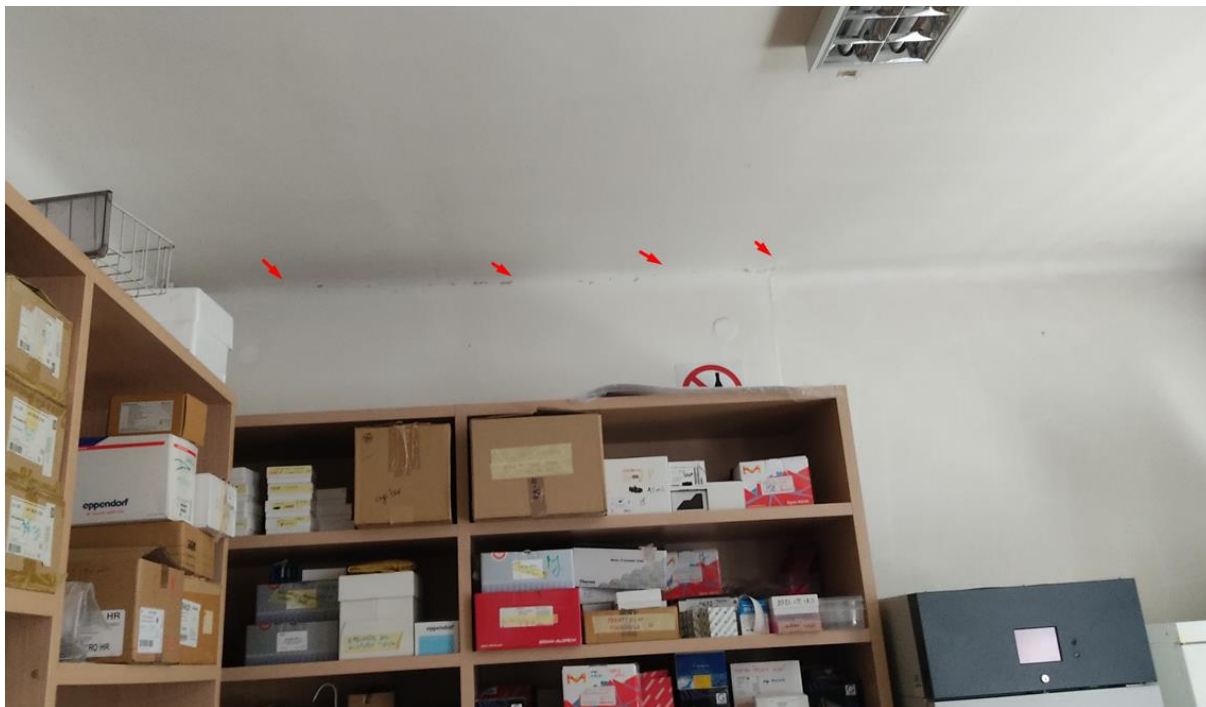
Slika 21 Pukotine na spoju zida sa stropnom konstrukcijom u prizemlju – Pozicija 9
