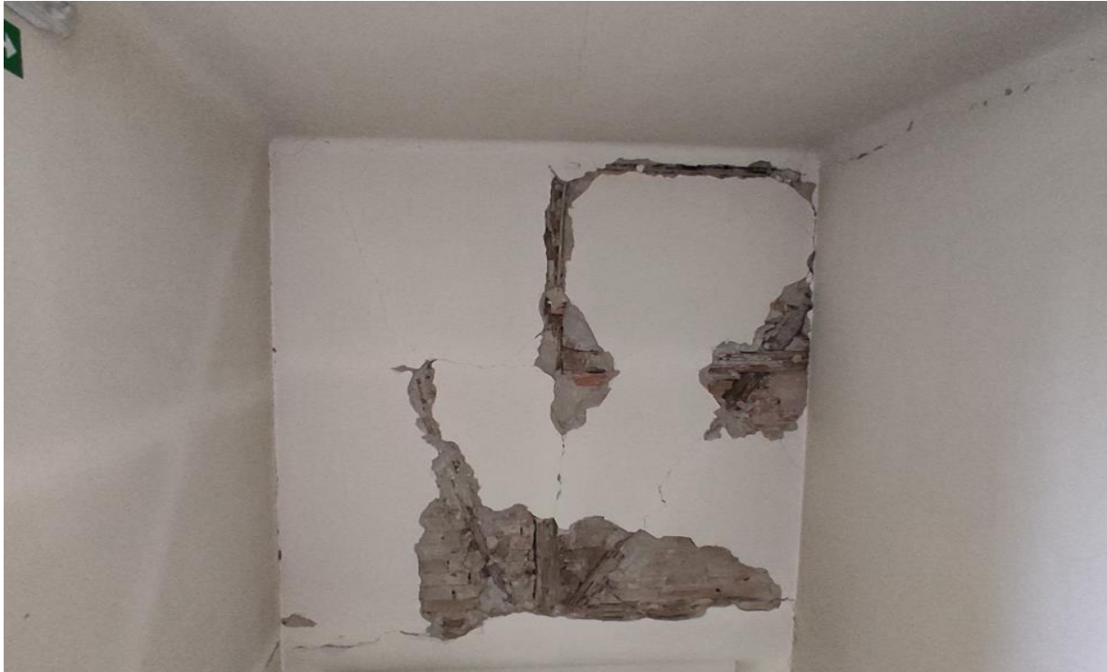
Slika 51 Pukotine na zidu u stubištu u razini 2. kata – Pozicija 36
