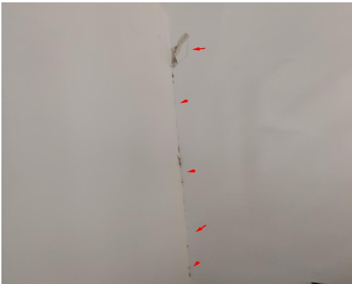
Slika 47 Pukotine na spoju zidova na 2. katu – Pozicija 32
