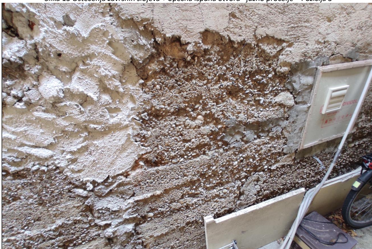
Slika 14 Oštećenja završnih slojeva nosivih konstruktivnih elemenata– južno pročelje – Pozicija 4
