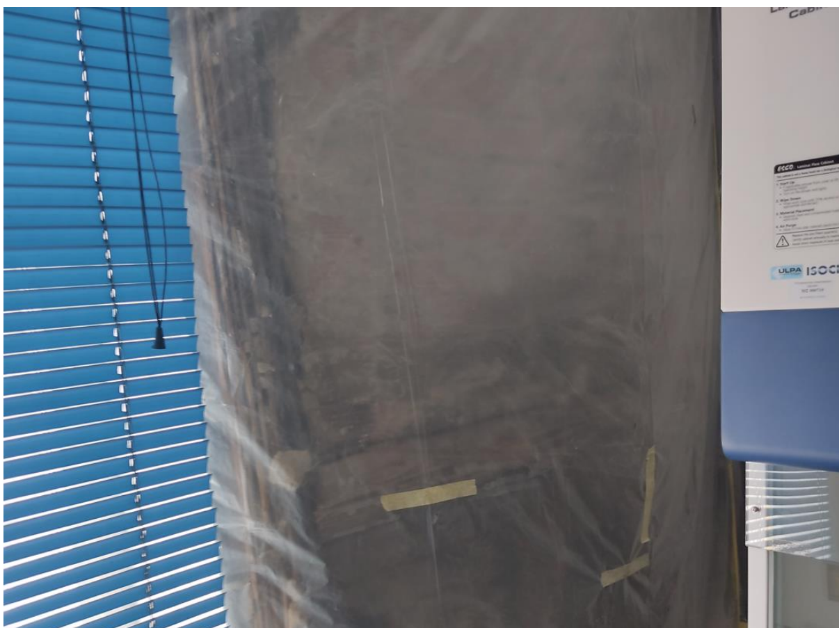
Slika 44 Pukotine na zidu na 2. katu – Pozicija 29
