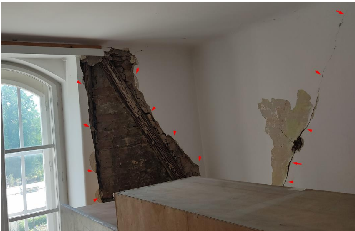
Slika 37 Oštećenja na mansardnom zidu izvedenom od komb. Opeke i drvenih elemenata na 2. katu – Pozicija 23
