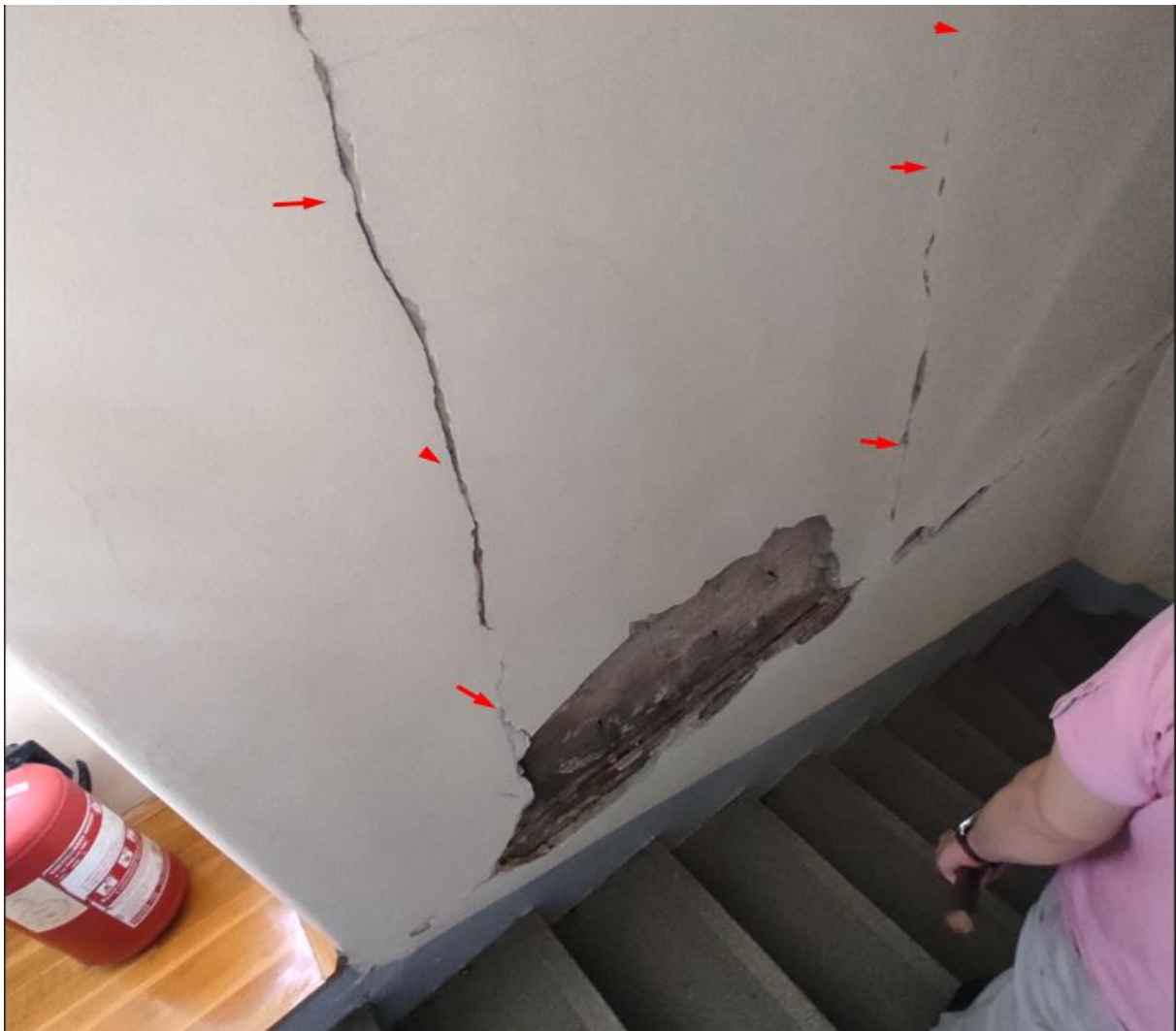
Slika 50 Pukotine na zidu u stubištu u razini 2. kata – Pozicija 35
