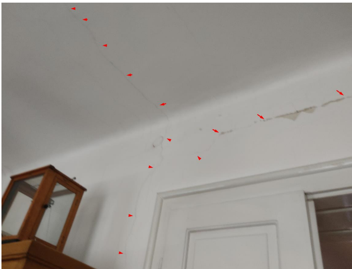
Slika 22 Pukotine na spoju zida sa stropnom konstrukcijom u prizemlju – Pozicija 10
