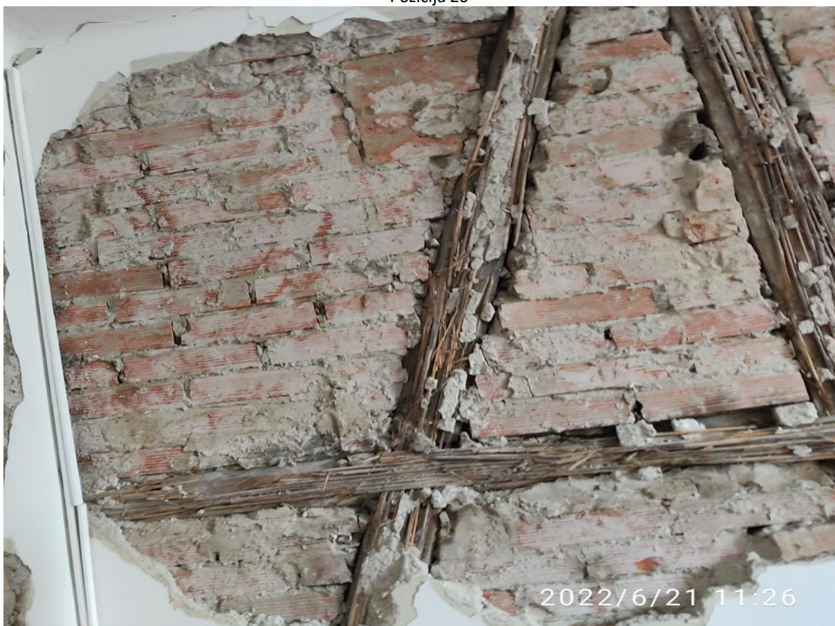
Slika 33 Oštećenja na mansardnom zidu izvedenom od komb. Opeke i drvenih elemenata na 2. katu
