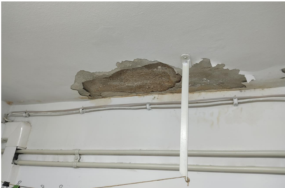
Slika 18 Oštećenja na stropnoj konstrukciji podruma nastala djelovanjem vlage – Pozicija 6
