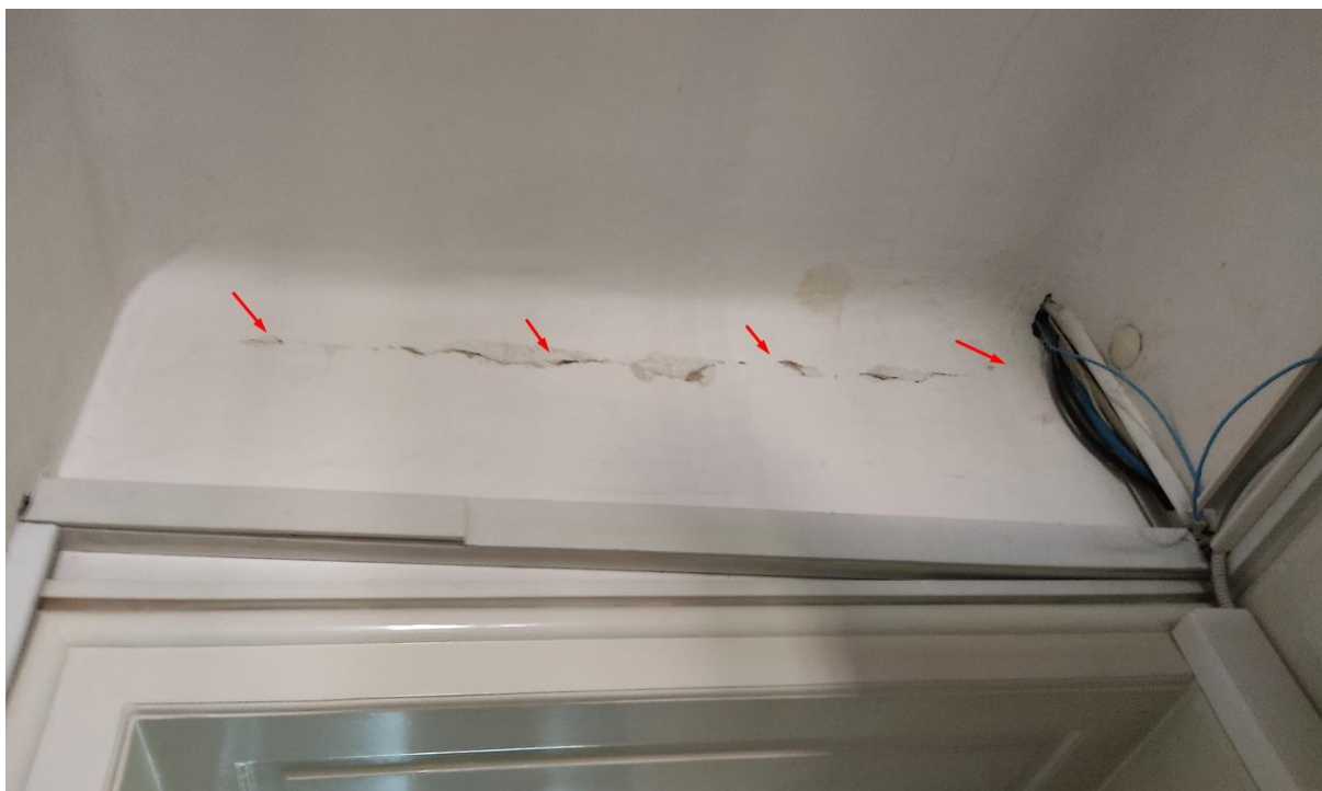
Slika 23 Pukotine na nadvoju iznad otvora u prizemlju– Pozicija 11
