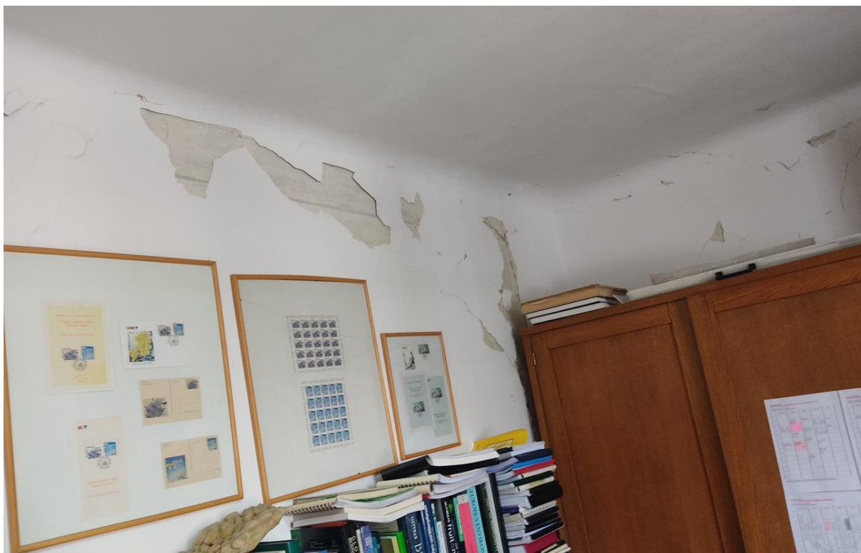
Slika 41 Pukotine na zidu na 2. katu – Pozicija 27
