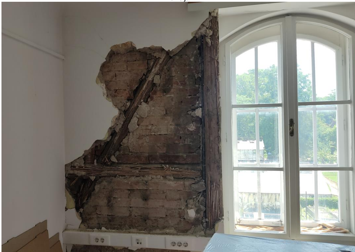
Slika 36 Oštećenja na mansardnom zidu izvedenom od komb. Opeke i drvenih elemenata na 2. katu – Pozicija 22
