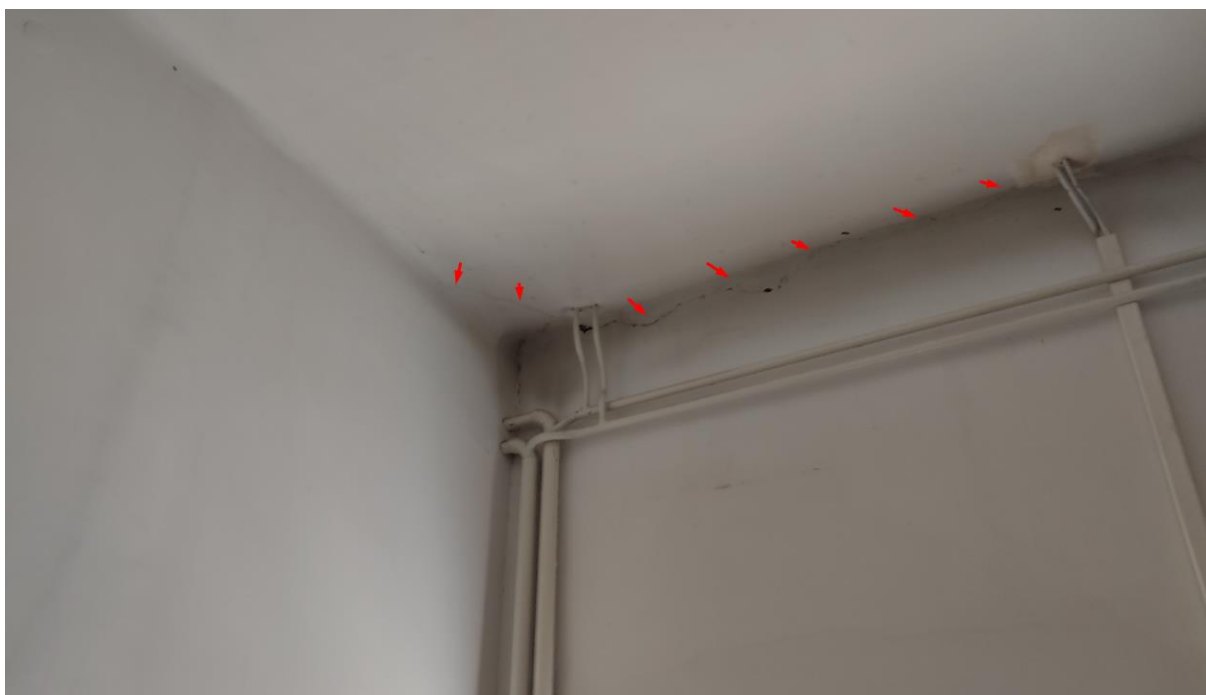
Slika 31 Pukotine na spoju zida sa stropnom konstrukcijom na 1. katu – Pozicija 19
