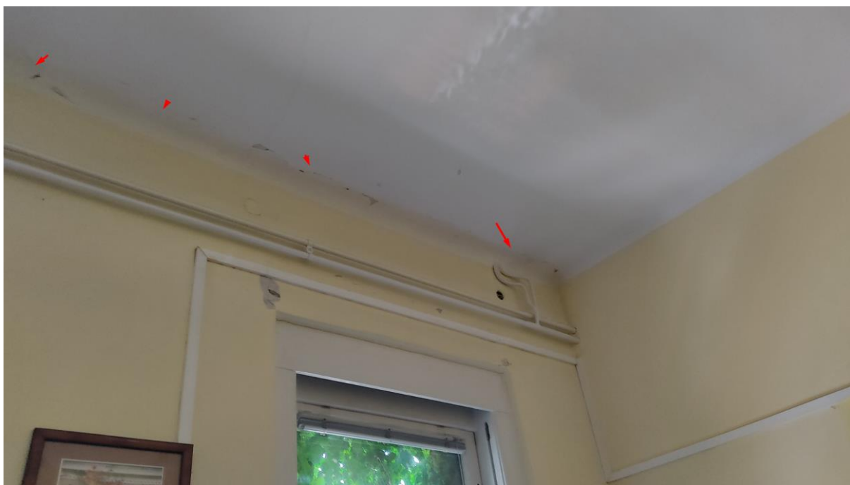
Slika 29 Pukotine na spoju zida sa stropnom konstrukcijom na 1. katu – Pozicija 17
