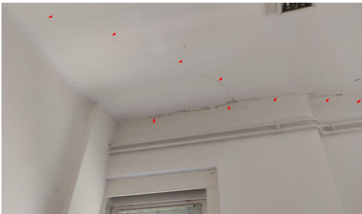
Slika 26 Pukotine na spoju zida sa stropnom konstrukcijom na 1. katu – Pozicija 14
