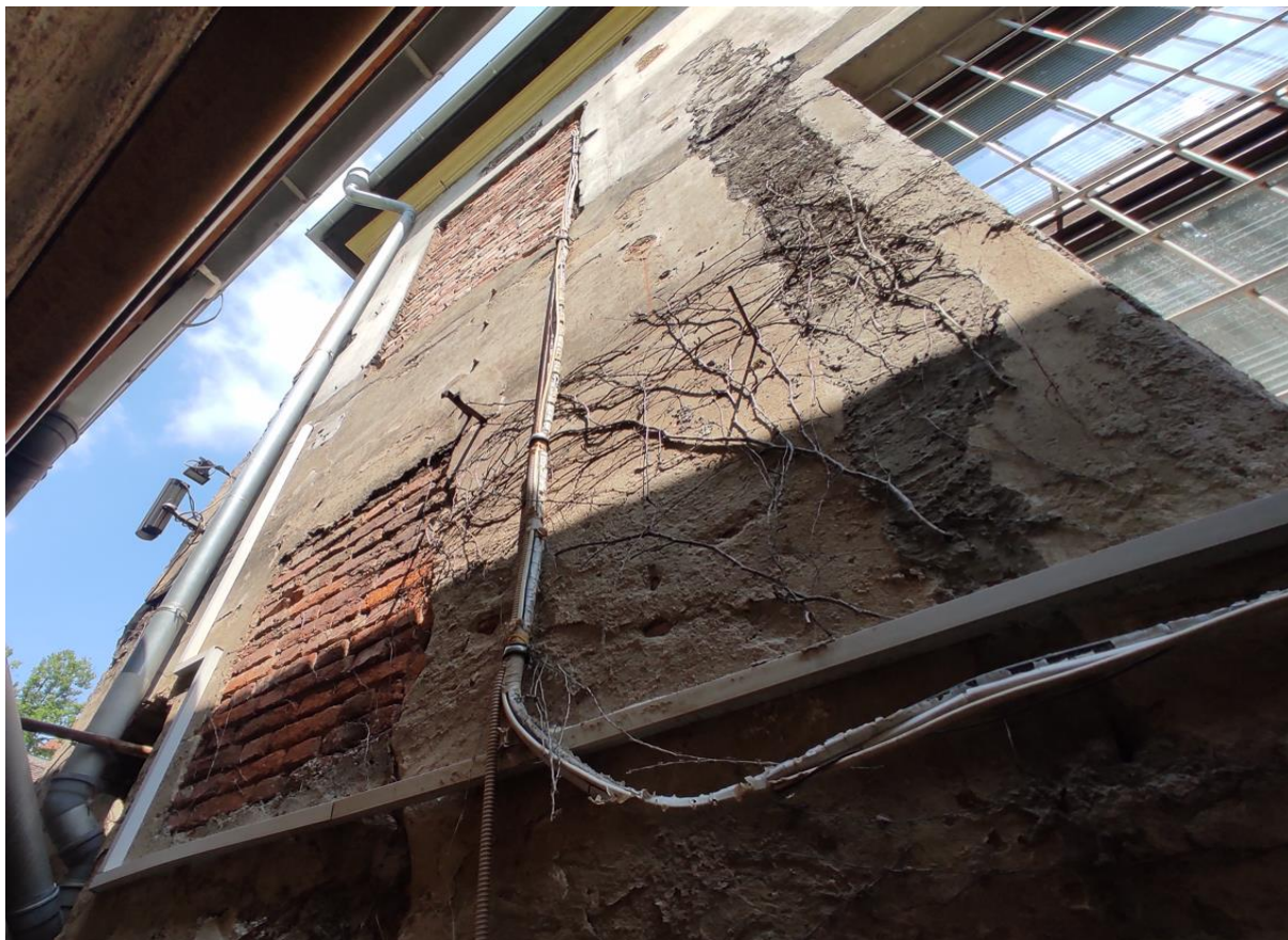
Slika 13 Oštećenja završnih slojeva + opečna ispuna otvora– južno pročelje – Pozicija 3
