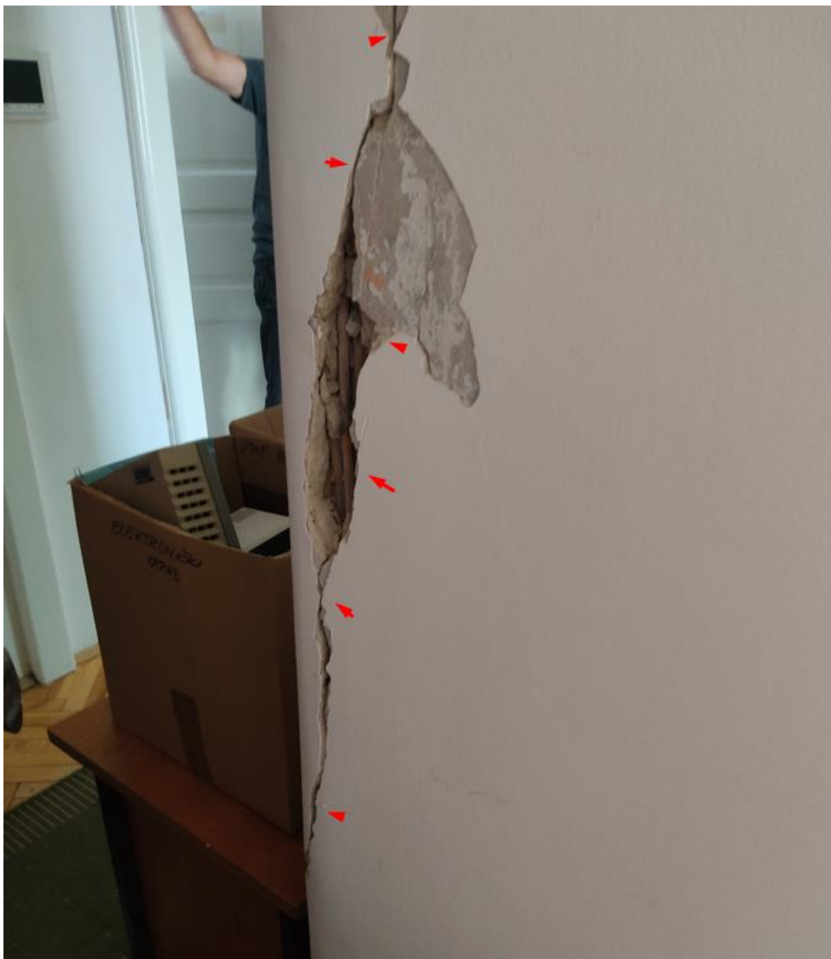
Slika 38 Pukotine zidu na 2. katu – Pozicija 24
