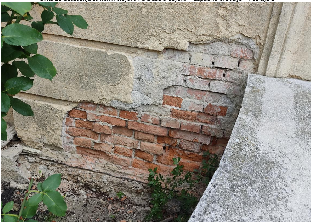
Slika 12 Oštećenja završnih slojeva na ulazu u objekt – zapadno pročelje – Pozicija 2
