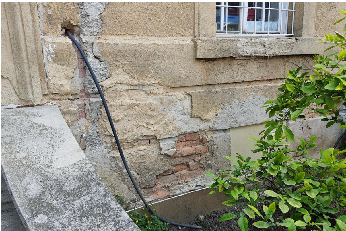
Slika 11 Oštećenja završnih slojeva na ulazu u objekt – zapadno pročelje – Pozicija 1
