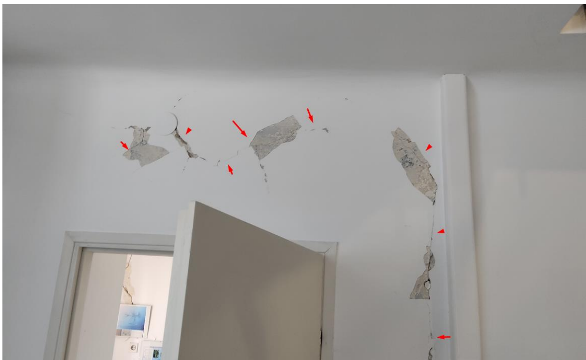
Slika 46 Pukotine na nadvoju iznad otvora na 2. katu – Pozicija 31
