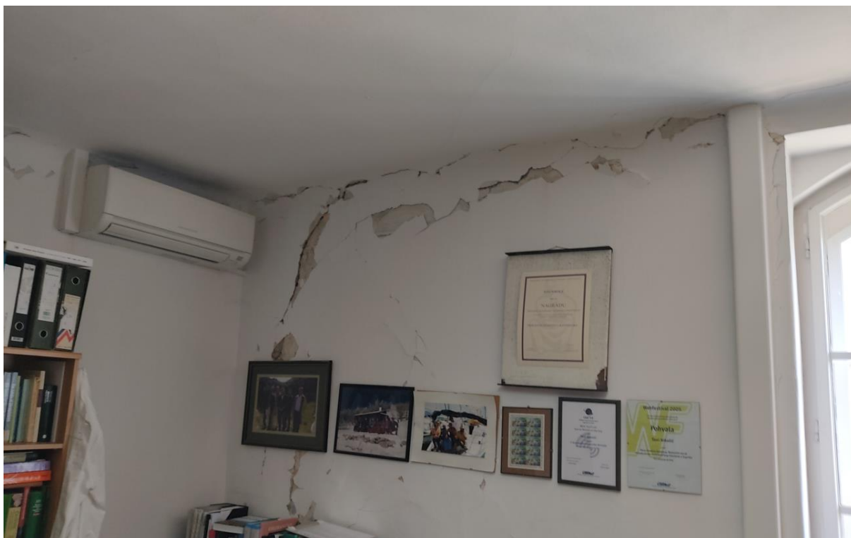
Slika 39 Pukotine zidu na 2. katu – Pozicija 25
